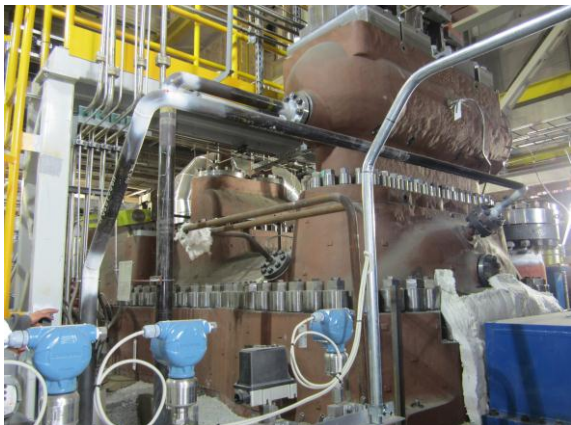
Zdj. nr 3 - Turbina przed izolacją
